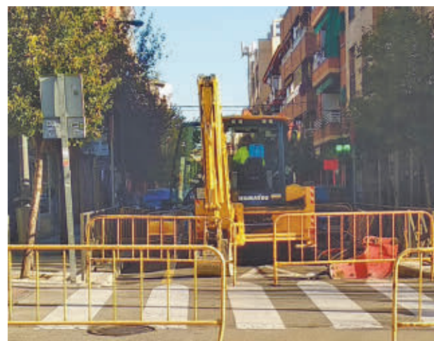
El hundimiento produce un desvío de líneas E.P
