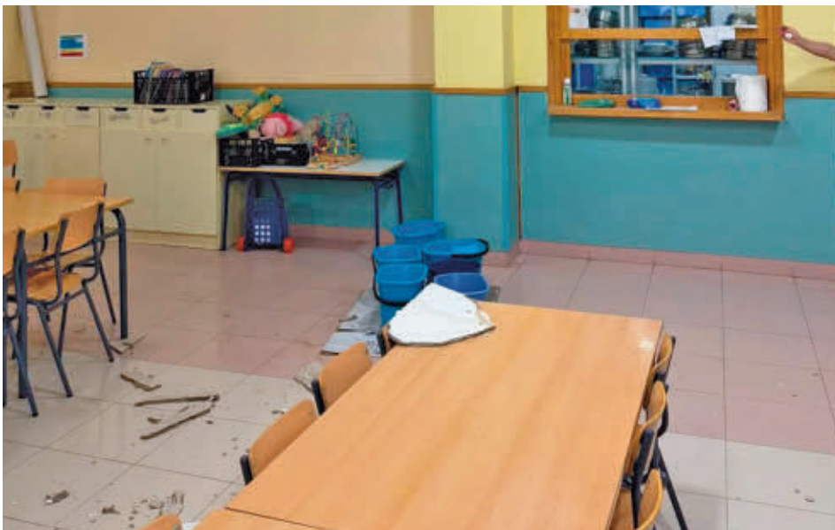
El techo del comedor se cayó hace unas dos semanas AMPA FUENTE DEL PALOMAR
