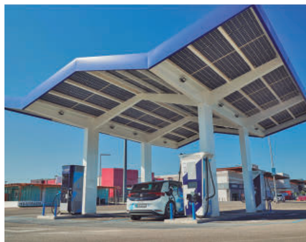
Estación de carga de vehículos eléctricos
