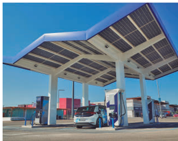
Estación de carga de vehículos eléctricos
