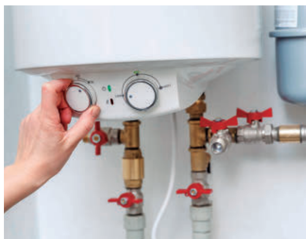
Caldera de gas
