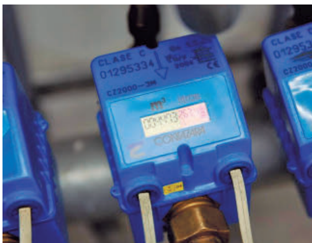
Contadores de agua
