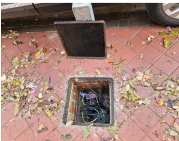
Parte del cobre que se estaba robando
