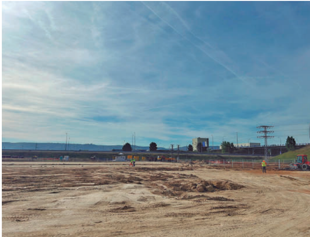
Una de las subestaciones que se está construyendo en el Corredor del Henares
