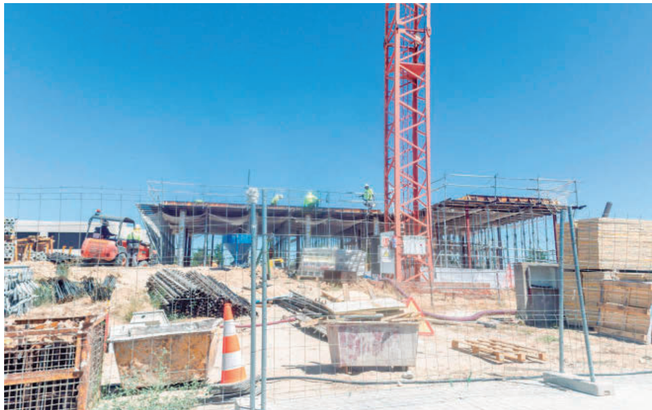
Bloque de viviendas en construcción en la Comunidad de Madrid EUROPA PRESS
