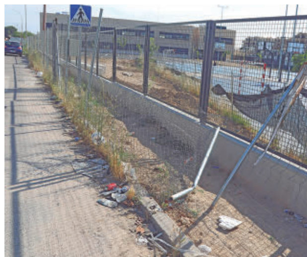
Estado de la calle objeto de la reclamación AYTO DE GETAFE
