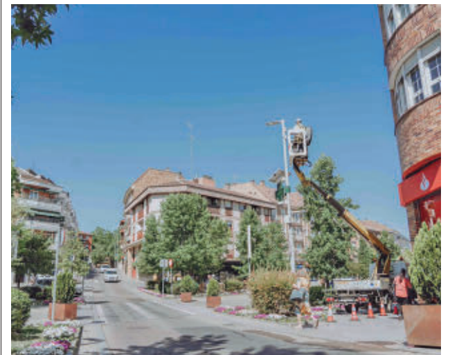
La instalación de uno de los dispositivos Sense One
