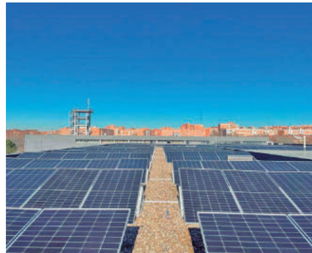
El balance incluye cuatro instalaciones solares AYTO DE ALCORCÓN
